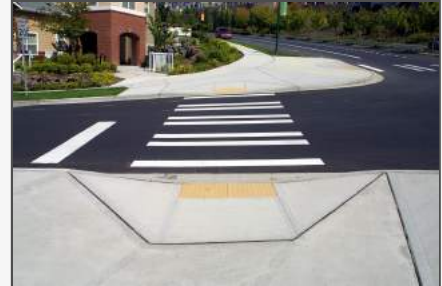
Curb Ramps pedbikeimages.org - Dan Burden (2006)
